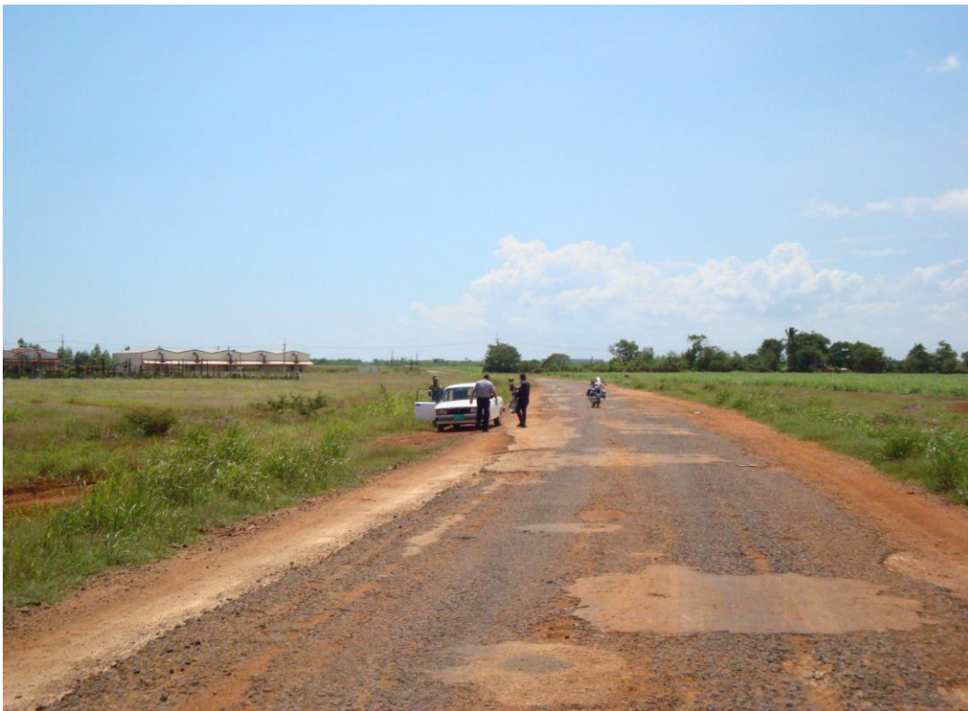
Foto 7: Accidente mortal de tránsito por mal estado del pavimento
